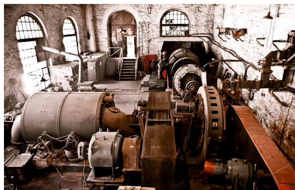
Машинный зал ГЭС
