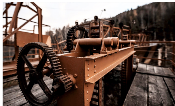
Привод водопропускных сооружений
